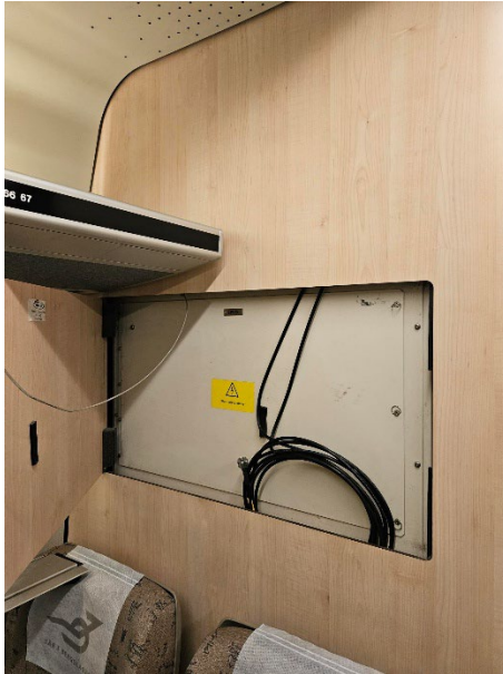
Figur 4 Antennkablage tåg mot takantenn
